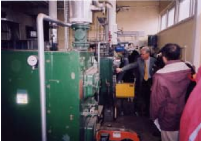
同工場で使用している温水ペレットボイラー (固定床) 1基 CTC 社製 出力 21kw オイルボイラー (バックアップ用) 1基
